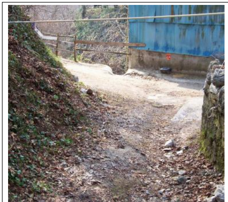
Foto 4 Vista del guado da monte: eventuali correnti di piena andrebbero ad interessare direttamente l'edificio in foto.
