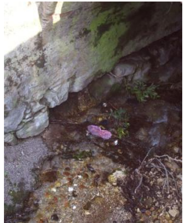
Foto 4 Particolare dell'erosione in sponda sinistra in corrispondenza della sezione di monte dell'attraversamento B
