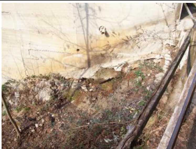
Foto 3 Particolare del muro dell'edificio con piede in erosione contiguo all'alveo del corso d'acqua in oggetto (a valle del guado)
