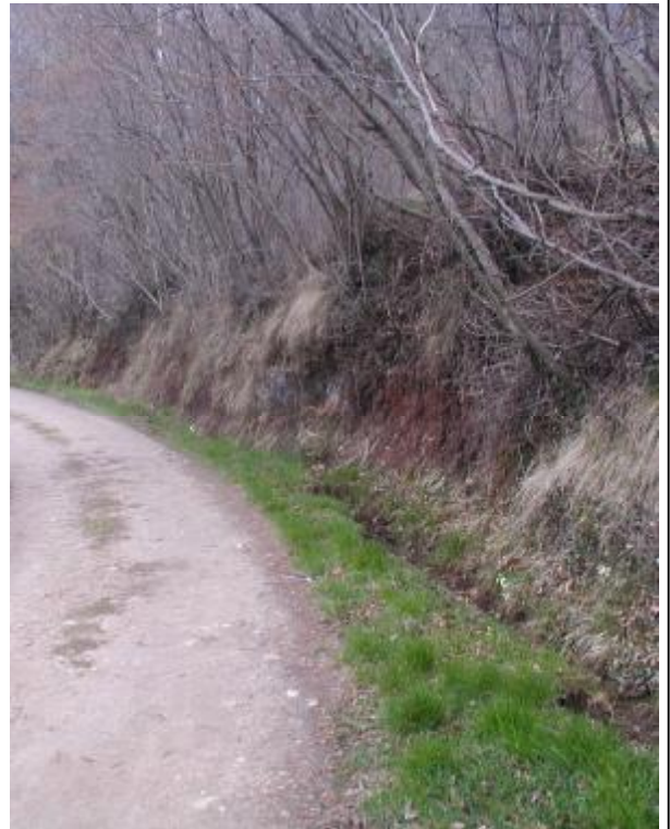
Foto 2 Tratto d'alveo lungo il lato di monte della strada vicinale degli Zoccoli
