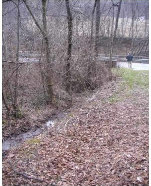
Foto 2 Detrito e resti vegetali in alveo a monte dell'attraversamento
