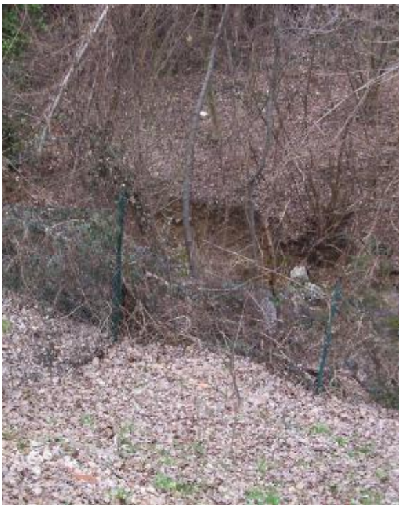
Foto 3 Sponde in erosione a monte dell'attraversamento B
