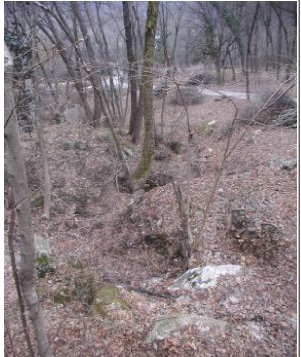
Foto 2 Detrito e resti vegetali in alveo immediatamente a valle dell'attraversamento
