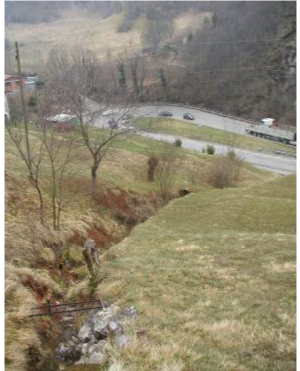
Foto 2 Detrito e resti vegetali in alveo a valle dell'attraversamento A
