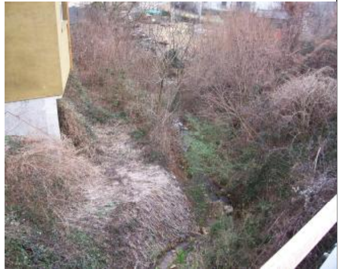
Foto 2 Detrito e resti vegetali in alveo a valle dell'attraversamento .
