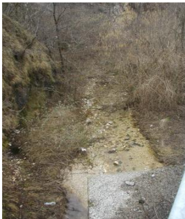
Foto 2 Detrito e resti vegetali in alveo a valle dell'attraversamento A
